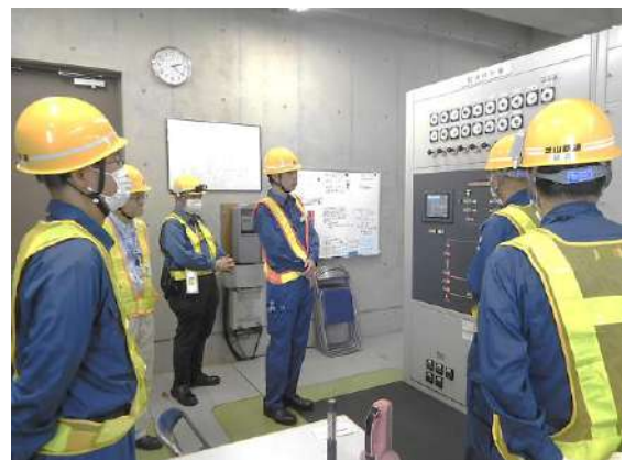
芝山変電所内
