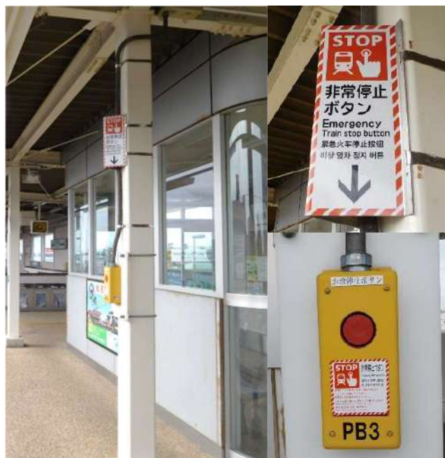
非常停止ボタン
