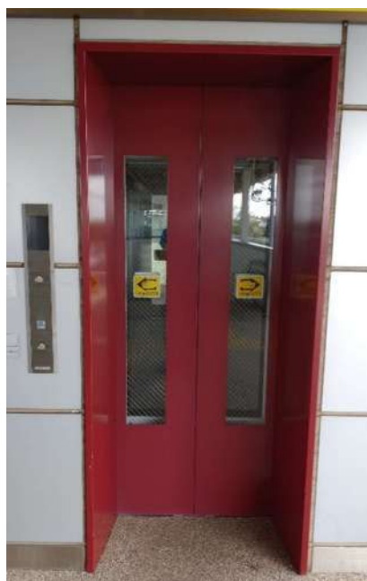
エレベーター
