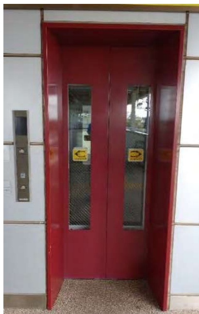
エレベーター
